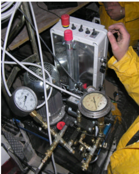
Foto: pompa di pressurizzazione
